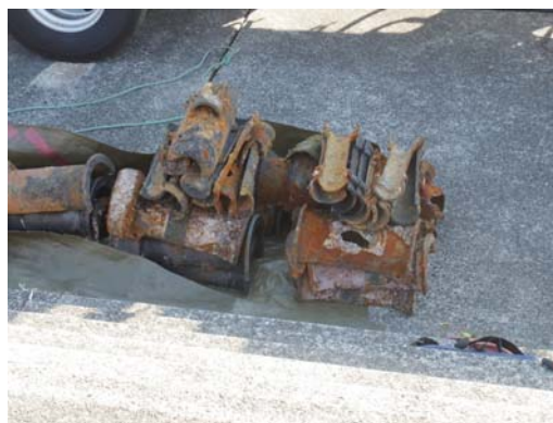
破損した室戸岬沖ケーブルの防護管
