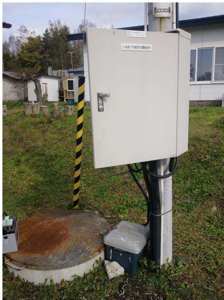
図3 観測点バッテリーで仮復旧
